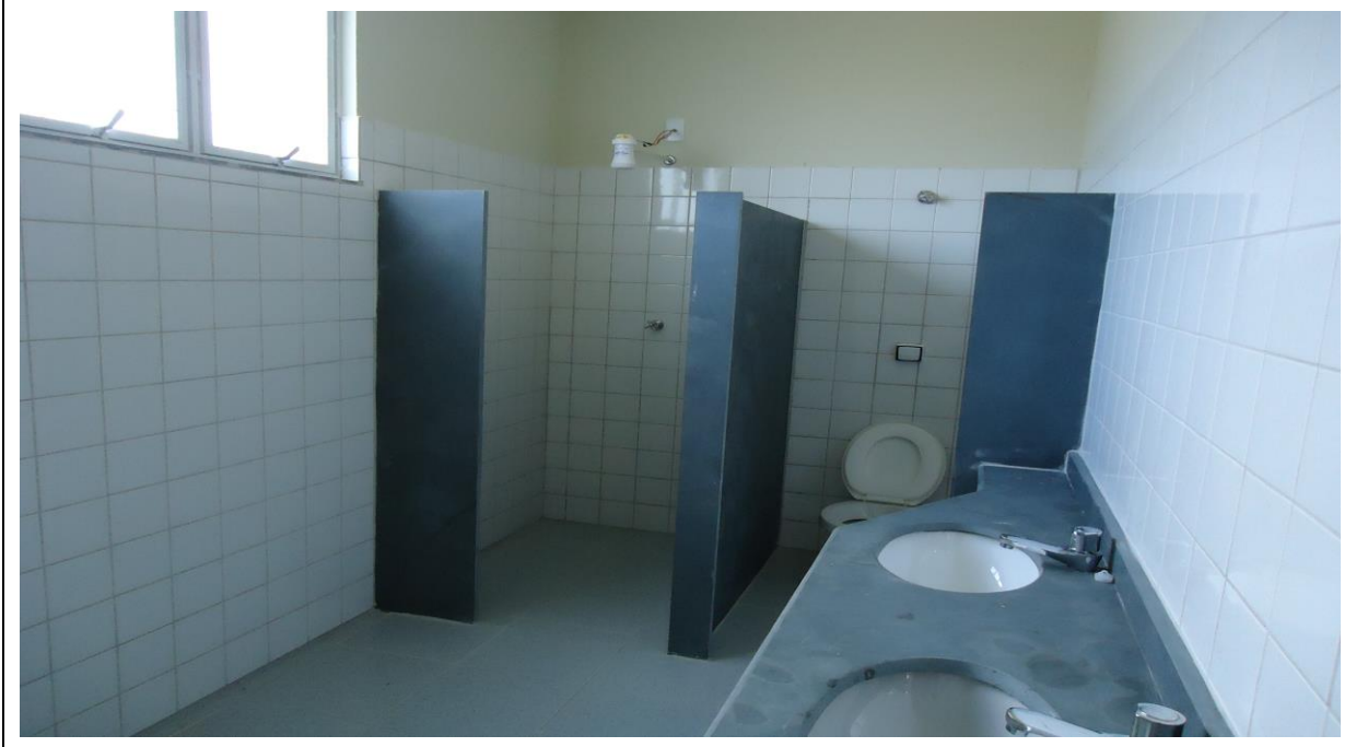
Foto 12 – UBS – Bairro Barcelona - Em 10/8/12
