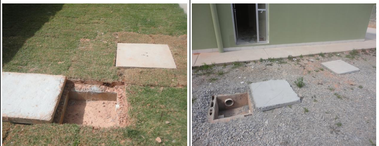
Fotos 15 e 16 – UBS – Barcelona - Caixas coletoras de esgoto
