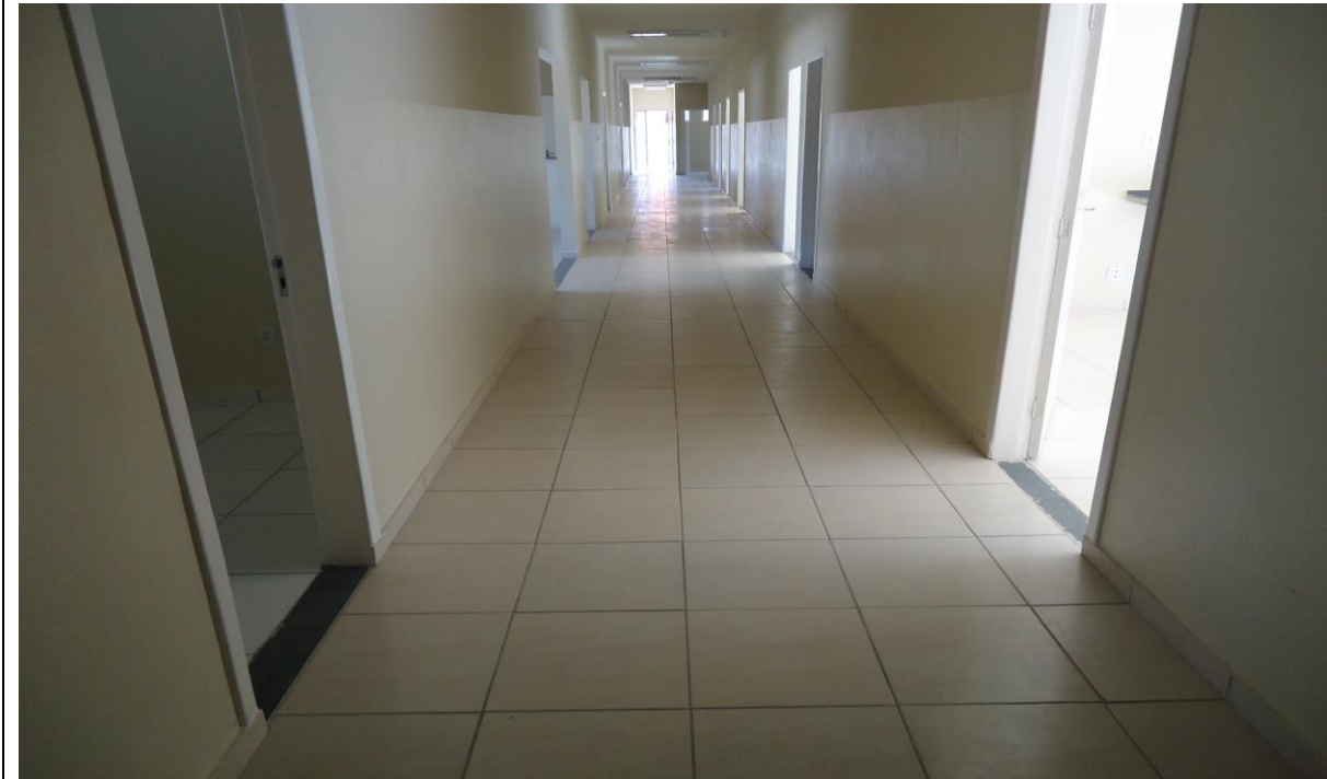
Foto 10 – UBS – Bairro Barcelona - Em 10/8/12
