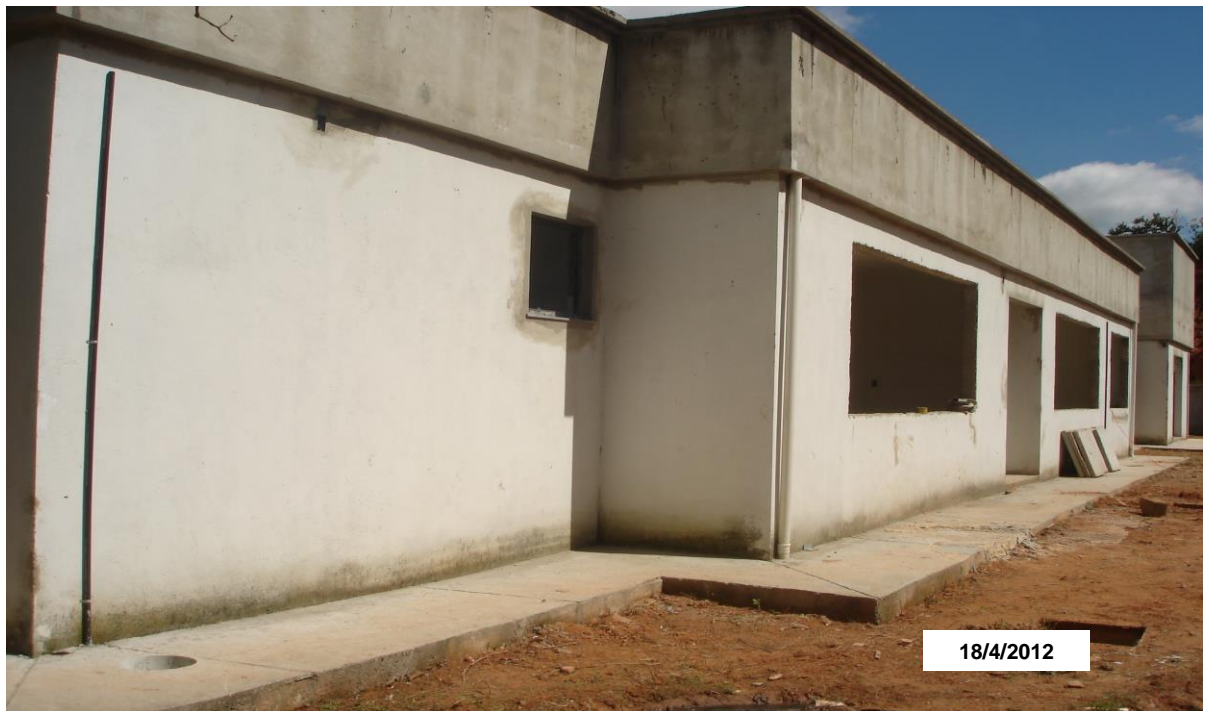
Foto 7 – UBS – Bairro Barcelona - Em 18/4/12
