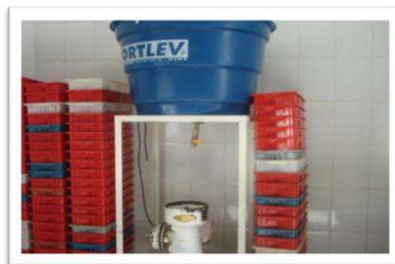
Foto 99 - Setor de desnate do leite – equipamento inadequado
