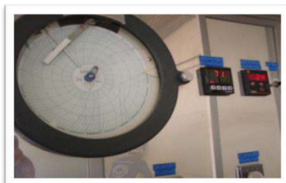
Foto 94 - Detalhe do painel de controle do pasteurizador com o termo-registrador automático
