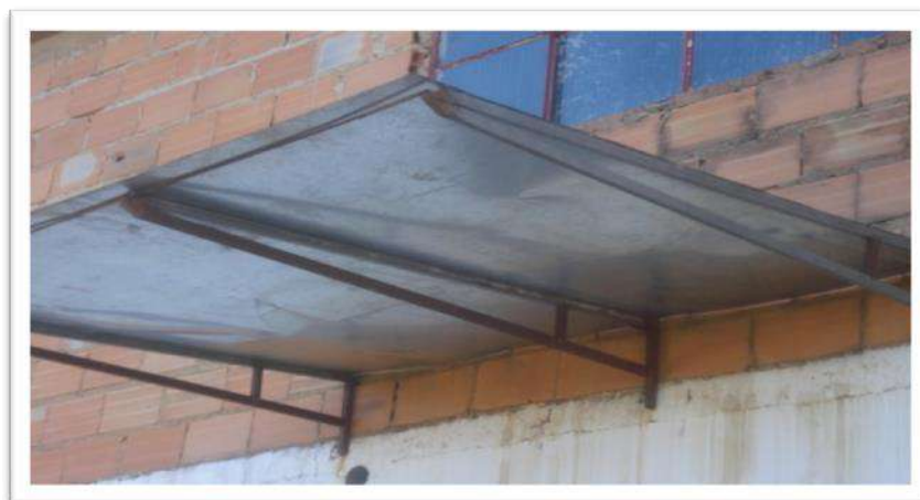
Foto 103 - Projeção da cobertura da expedição insuficiente e impermeabilização da parede inacabada
