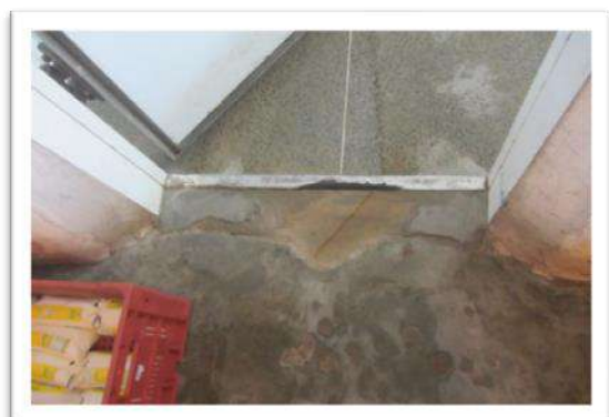
Foto 108 - Condições inadequadas do piso do estabelecimento
