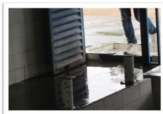
Foto 107 - Acesso inadequado ao setor de produção (estrutura física deficiente e ausência de gabinete sanitário)
