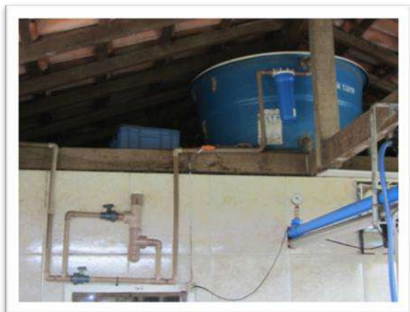
Foto 60 - Caixa d'água com filtro e sistema de cloração
