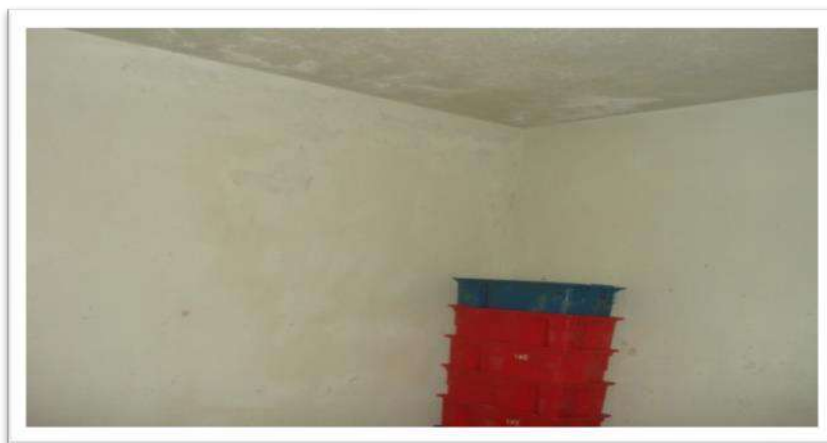
Foto 102 - Câmara fria – teto e parede em condições e local incompatível para a estocagem de caixas inadequadas
