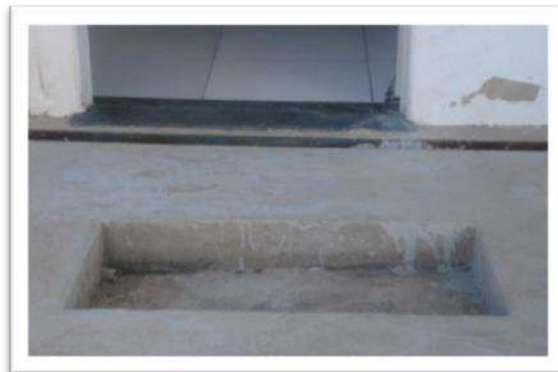
Foto 101 - Acesso inadequado ao laboratório
