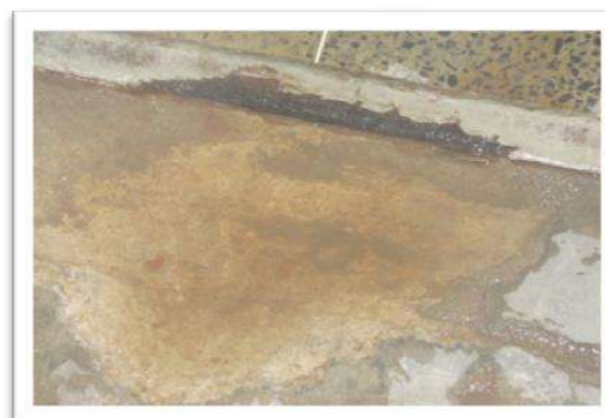
Foto 109 - Condições inadequadas do piso do estabelecimento
