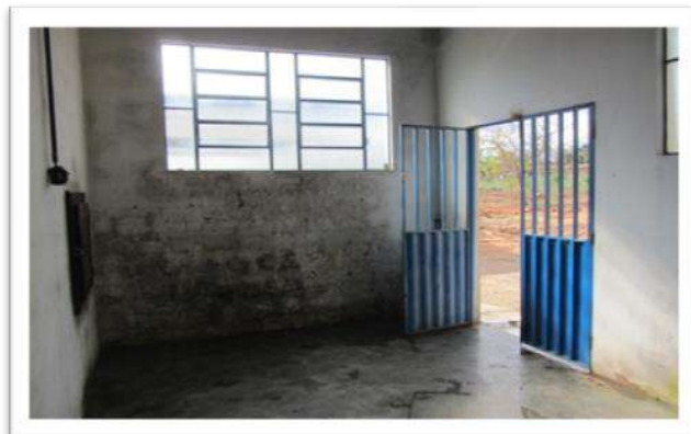
Foto 110 - Condições inadequadas da estrutura física do setor de expedição
