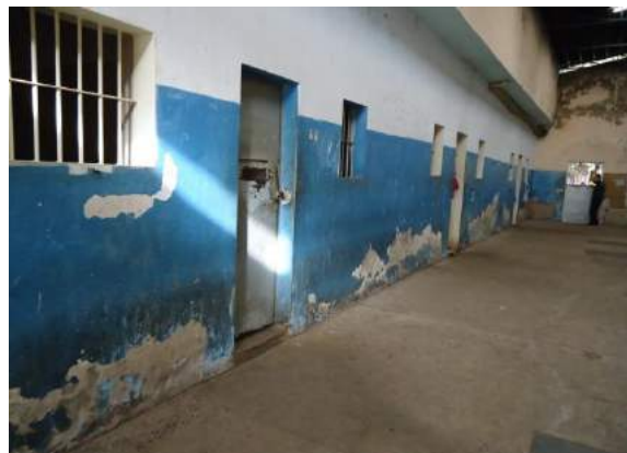
As infiltrações já tomaram conta de todos os blocos do Núcleo I
