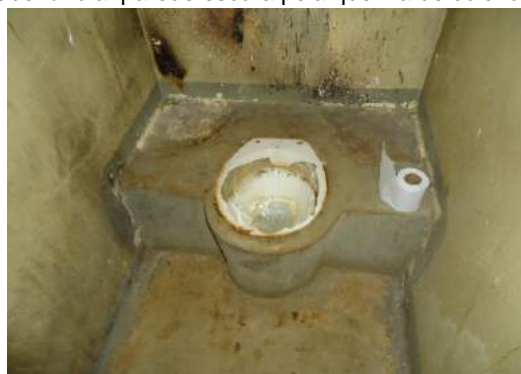
Uberlândia: vaso sanitário quebrado
