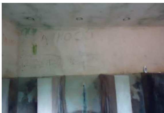
Ducha no teto do banheiro do Núcleo I
