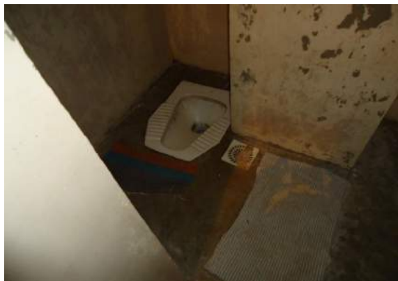
Vaso sanitário do alojamento do Núcleo I
