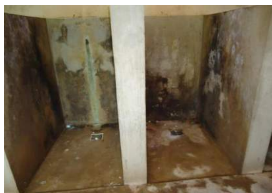
Núcleo I: O local do banho está cheio de infiltrações e é muito fétido
