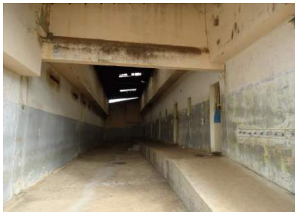
Núcleo I: alojamentos mal iluminados, muito úmidos e cheios de infiltrações.
