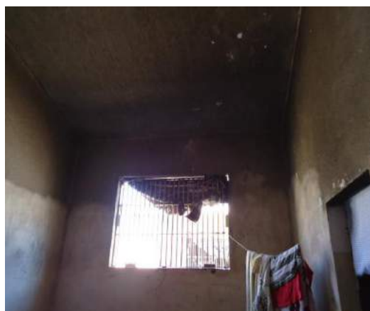
Uberlândia: parede escura pela queima de colchões
