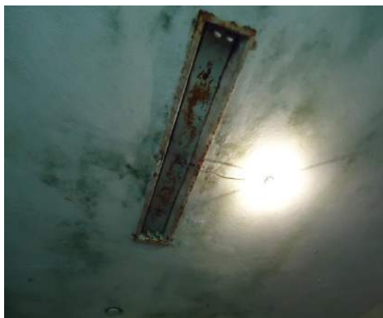
Núcleo I: Teto do banheiro cheio de infiltrações com iluminação precária
