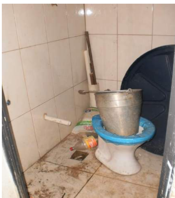
Foto 13 - Ausência de lavatório e vaso sanitário sem instalar.
