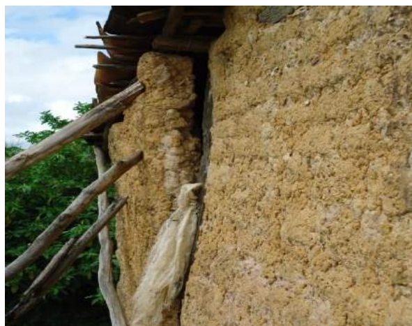
Foto 82 - Visão da fresta da parede que está para cair.
