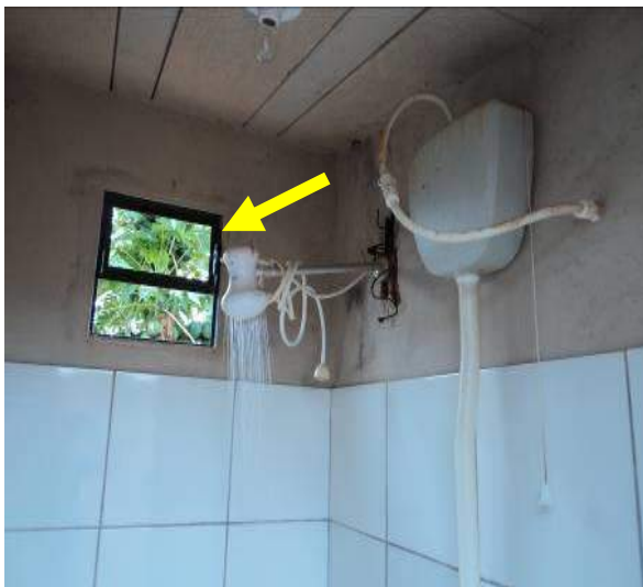
Não instalação dos vidros da janela.
