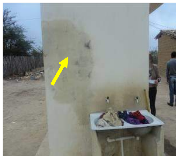
Infiltração na parede.
