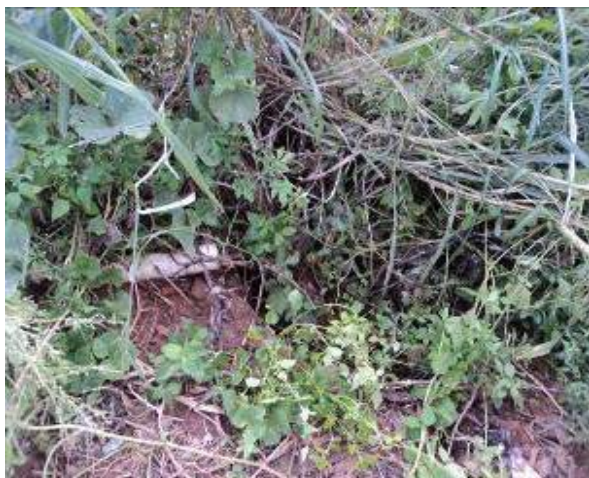
Foto 21 - Ausência de tampa de concreto da fossa.
