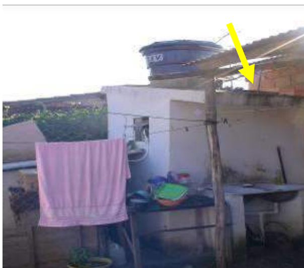
Pontos de infiltração na laje.
