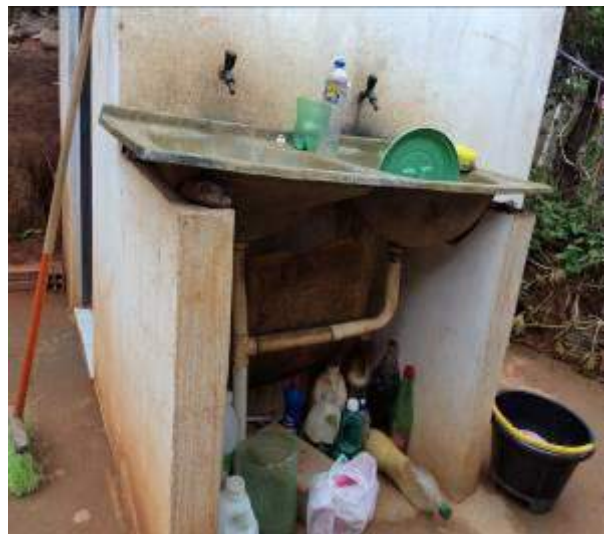
Assentamento do tanque de forma inadequada (está solto).
