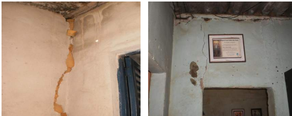
Fotos 9 e 10 - Residências com estrutura comprometida.
