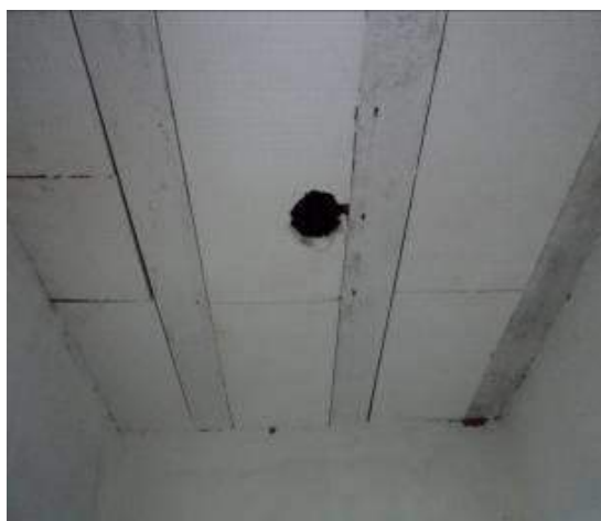
Foto 19 - Ausência de complementos hidráulicos.
