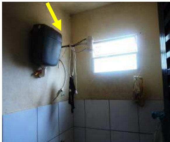
Encanamento do chuveiro colocado muito próximo à parede da janela.
