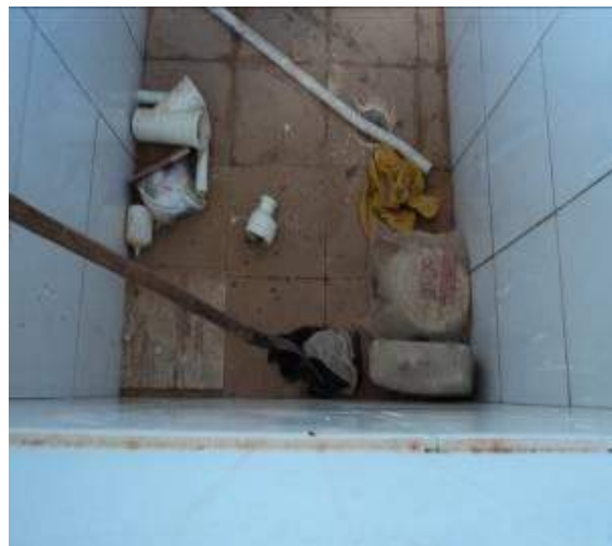
Foto 18 - Ausência de chuveiro.
