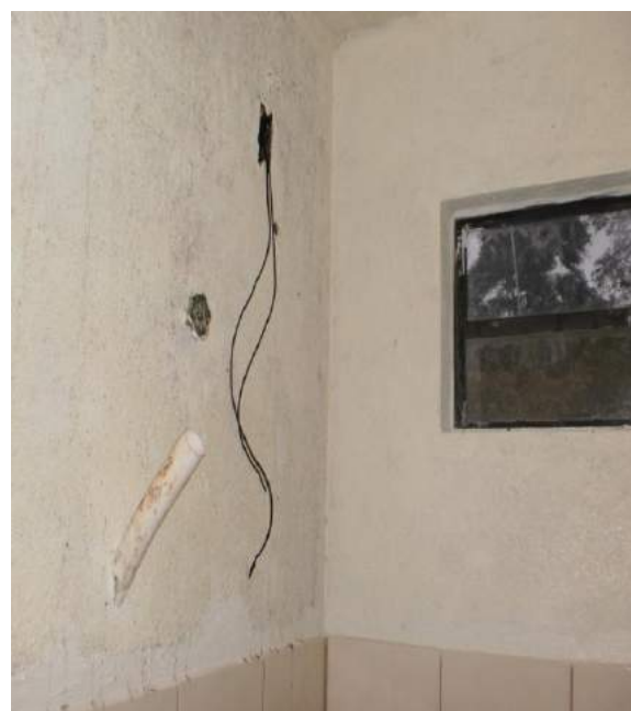
Foto 14 - Ausência da descarga, braço e chuveiro.
