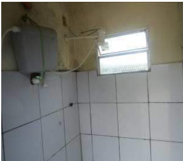
Caixa de descarga mal instalada, amarrada para não cair.
