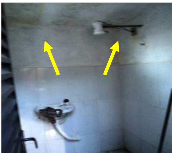
Pontos de infiltração na laje.
