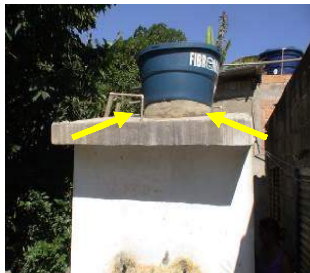
Altura da caixa d'água abaixo da indicada pelo projeto, contribuindo para o mau funcionamento do chuveiro.
