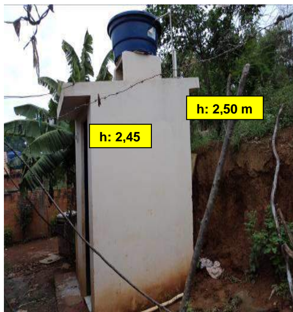
Inclinação da laje em desacordo com o projeto.
