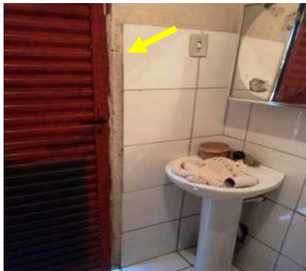
Revestimento cerâmico incompleto.
