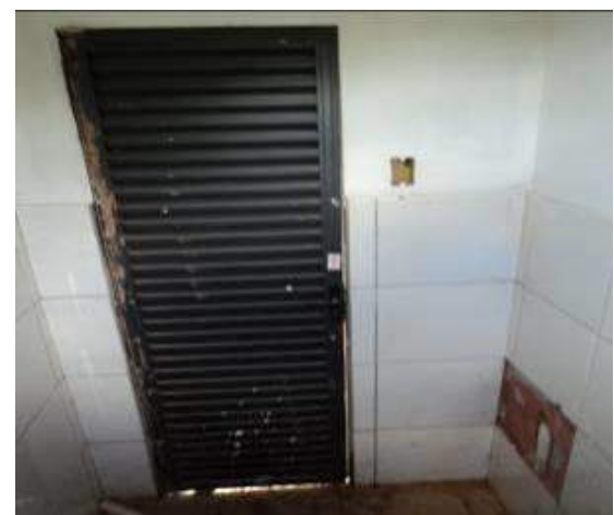
Foto 20 - Ausência de acabamentos (cerâmica e parte elétrica).
