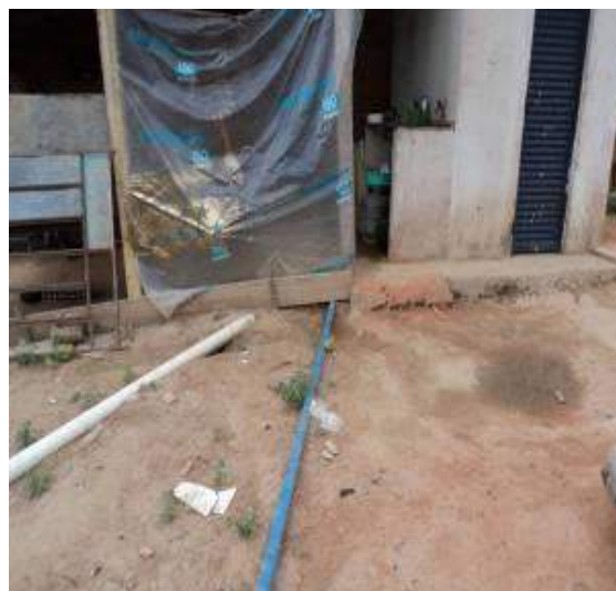
Canos de esgoto e de dispersão das águas de serventia sem enterrar, causando desgaste precoce do material.
