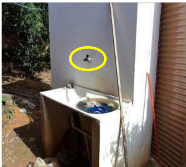
Ausência do outro ponto de saída d'água com torneira sobre o tanque (neste caso, a única saída de água está posicionada no centro das duas cubas do tanque).
