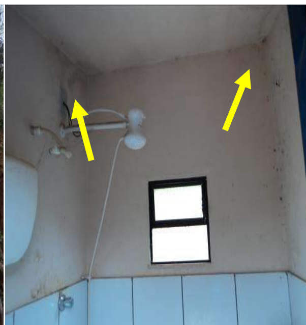
Sinais de infiltração na laje e parede.
