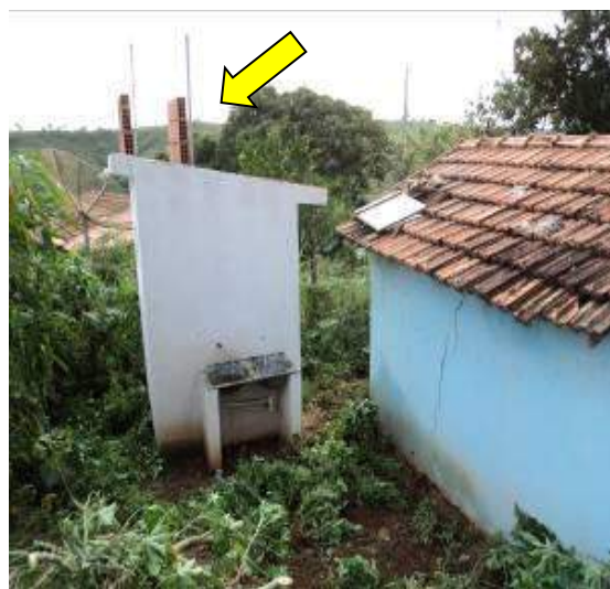
Foto 16 - Falta da caixa d'água.
