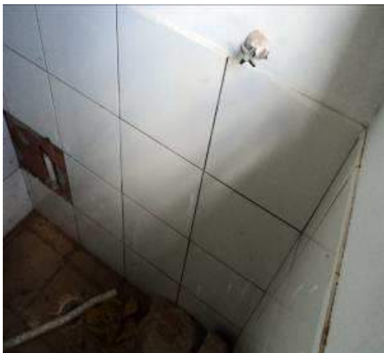
Foto 17 - Ausência de bacia sanitária.
