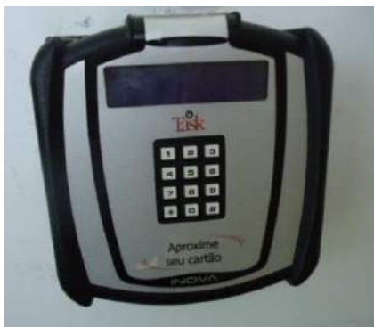
Telecom T.4 do 3º andar do prédio Minas 22/11/2012
