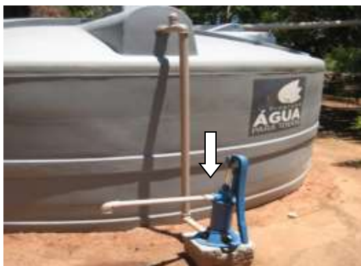
Foto 36 - Bomba de ferro - Montes Claros (cisterna nº 00002).
