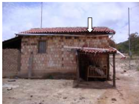
Foto 23 - Calha envergada (vista lateral) – Cristália.
