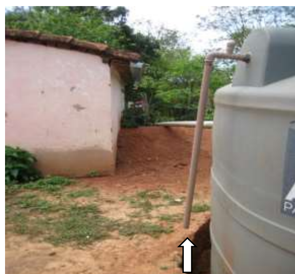
Foto 45 - Cano desconectado (cisterna nº 00775) - Montes Claros.
