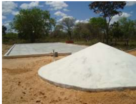
Foto 2 – Cisterna de placas 2ª água (52.000l)
