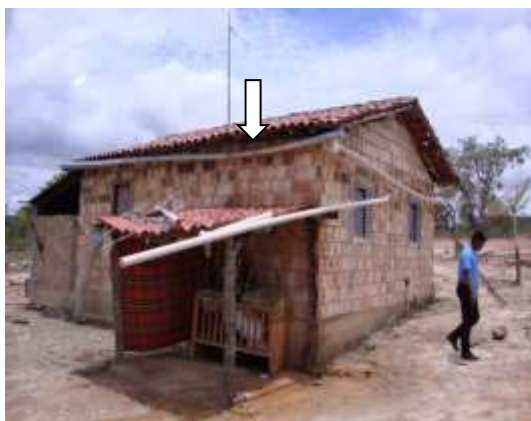
Foto 22 - Calha envergada (cisterna nº 7.157) Cristália.
