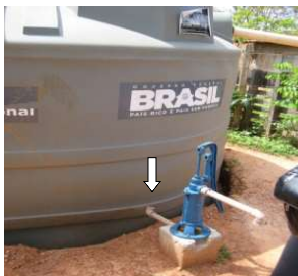
Foto 44 - Bomba desconectada (cisterna nº 00775) - Montes Claros.
