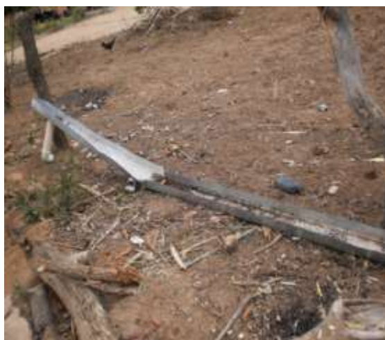
Foto 24 - Calha amassada e desconectada do telhado (cisterna nº 6.800) – Cristália..
