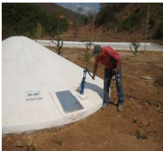
Foto 16 – Cisterna de 2ª água (nº 00.387) – Chapada do Norte.
