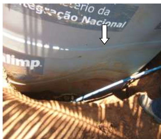
Foto 40 - Instalação inadequada (cisterna nº 00259).
