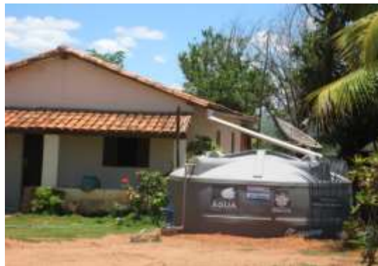
Foto 33 - Cano de PVC conectando calha à cisterna nº 00259.
