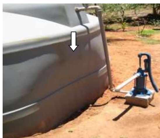
Foto 41 - Instalação inadequada (cisterna nº 000259).
