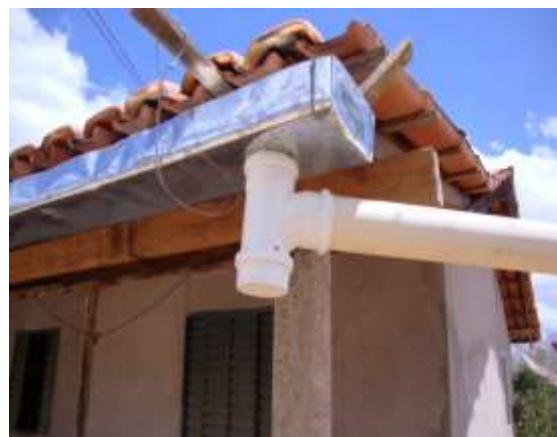
Foto 13 - Calha conectada ao tubo (cisterna nº 13.042) - Januária.
