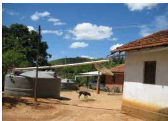
Foto 35 - Cano de PVC conectando calha à cisterna nº 00114.
