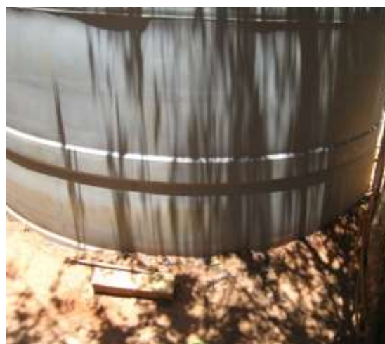
Foto 39 - Cisterna nº 00285 instalada adequadamente, sem amassados.
