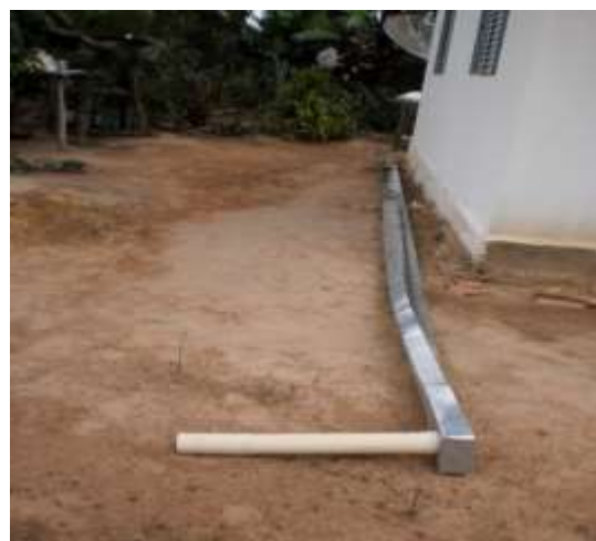
Foto 25 - Calha desconectada do telhado (cisterna nº 6.800) – Cristália..
