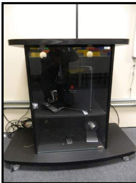
Figura 4 – Rack da Sala de Videoconferência sem o suporte duplo (UAITEC - Contagem)
